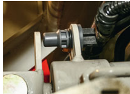
Der Näherungsschalter sieht, ob die Transportverriegelung offen oder geschlossen ist.
